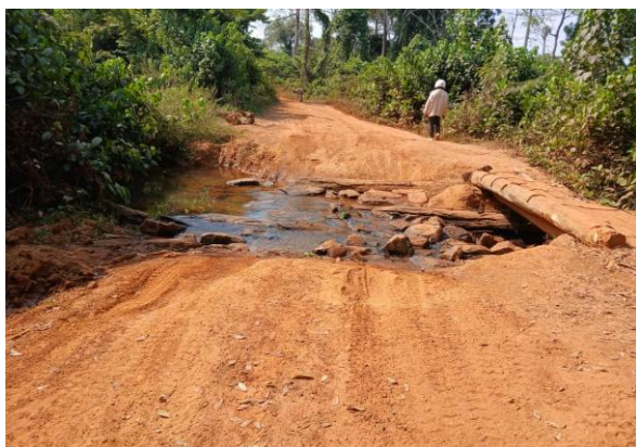
Vue de la piste dégradée à 3 carrefours
